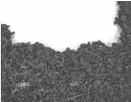
Fig. - Tappetino antiscivolo in granulato, danneggiamenti a forma di "pallini"
